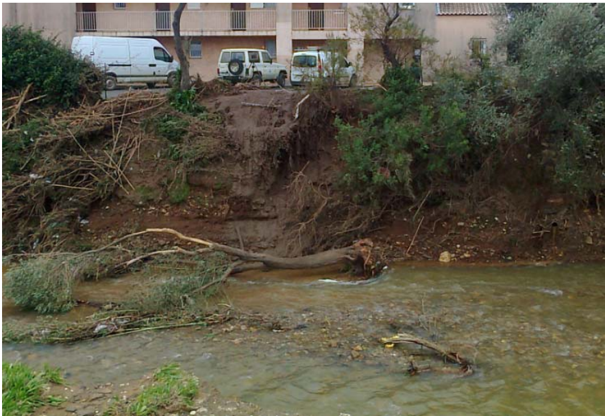
Photo 12 Érosion en rive droite du Pansard en amont de la confluence
