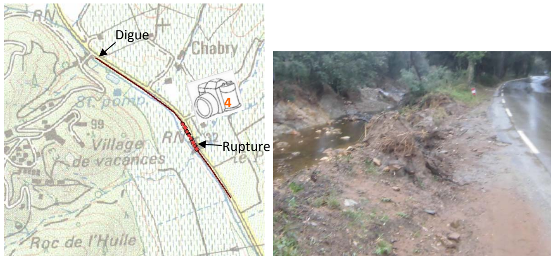
Photo 4 Brèche sur une digue en rive gauche du Pansard
