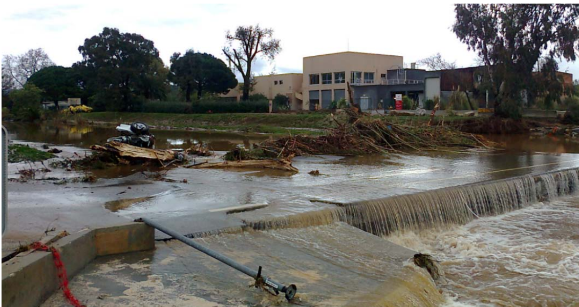
Photo 14 Pont cadre submersible d'accès au port après la crue de janvier 2014
