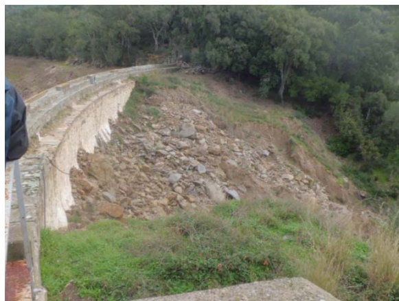
Photo 7 Barrage nord de Valcros, effondrement du talus aval vu depuis la rive droite
